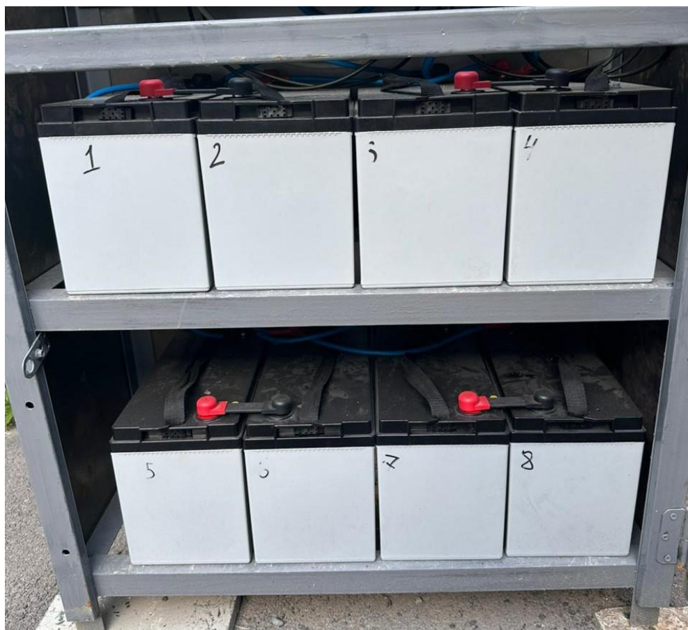
Рисунок 2.7 - Аккумуляторные батареи на 12 В
