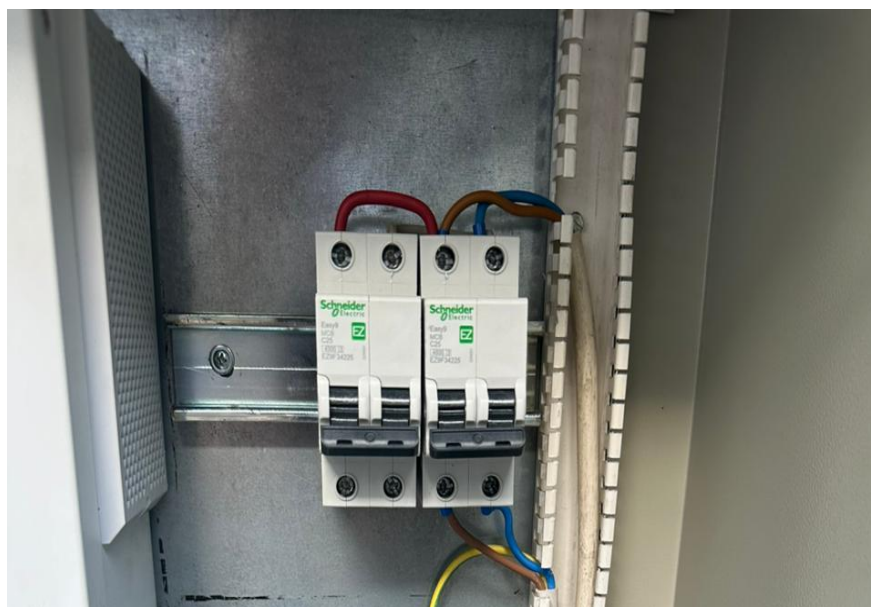
Рисунок 2.11 – Защитные автоматы линии переменного напряжения на 25
