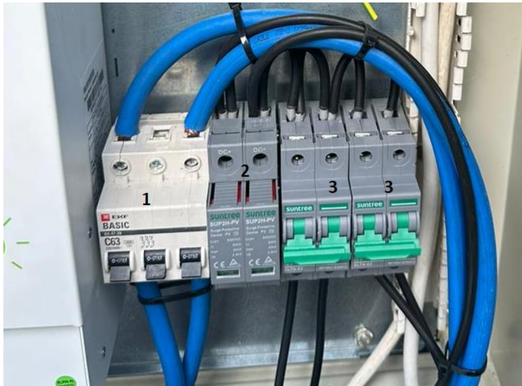
Рисунок 2.8 - Защитные автоматы линии постоянного напряжения на 25 А
