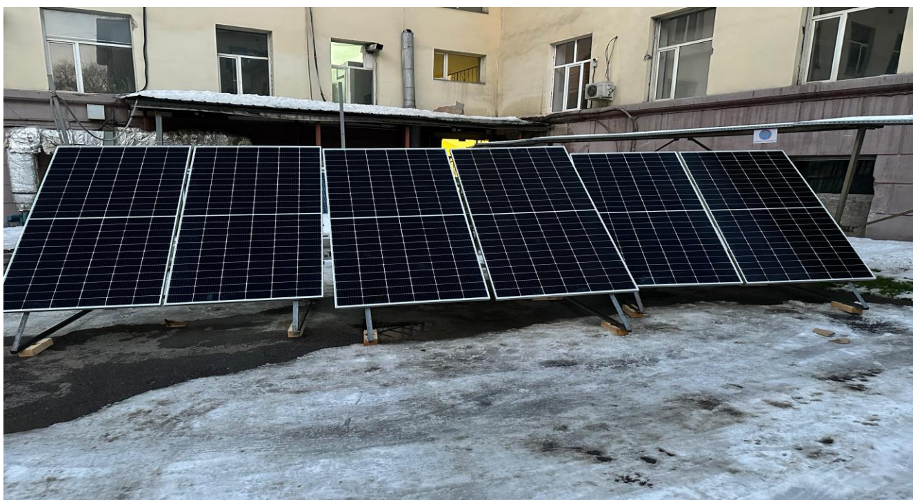
Рисунок 2.4 - Солнечные панели на 3 кВт
